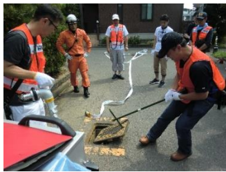
「消火栓セット」
